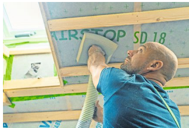
Das Hybrid-Dach kombiniert PU-Aufsparrendämmung und Zellulose-Einblasdämmung. Foto: HLC/Linzmeier
