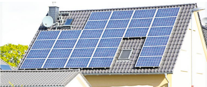
Wer selbst erzeugten Solarstrom speichert und später nutzt, kann den Netzbezug reduzieren und Kosten sparen. Foto:Nestor Bachmann/dpa-mag
