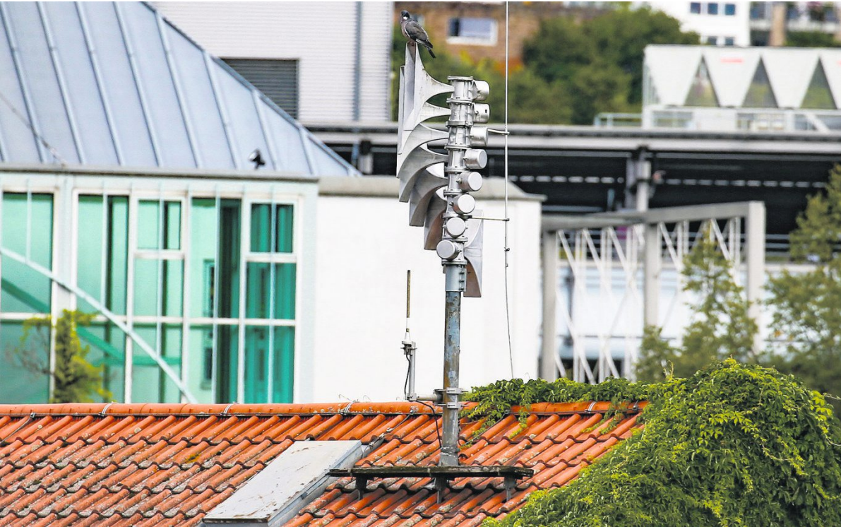
Sirenen auf dem Dach des Enzkraftwerks in Bietigheim-Bissingen. Foto: Martin Kalb
