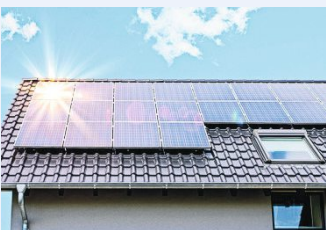
PV-Anlage auf dem Dach. Foto: Alessandro Terranova
